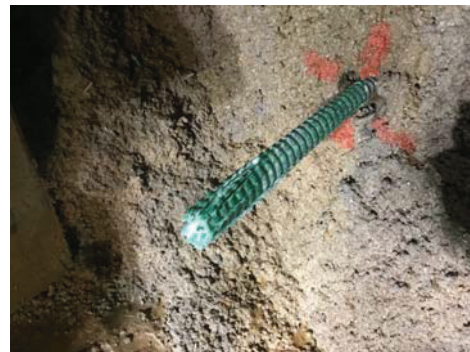
写真-3 従来品端部の破損状況
